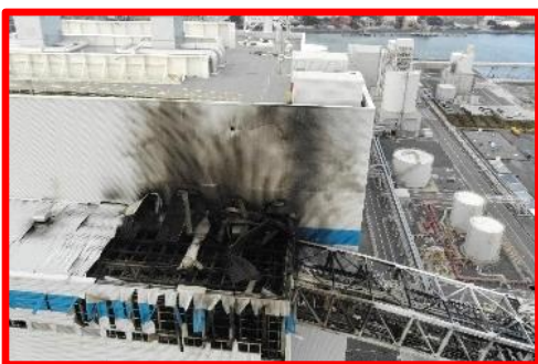
①: 粉じん爆発による損傷
