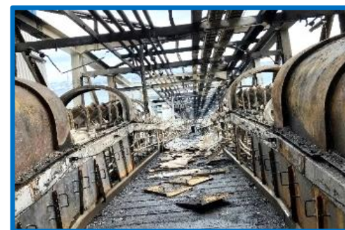
②: 爆発の広がりによる損傷
